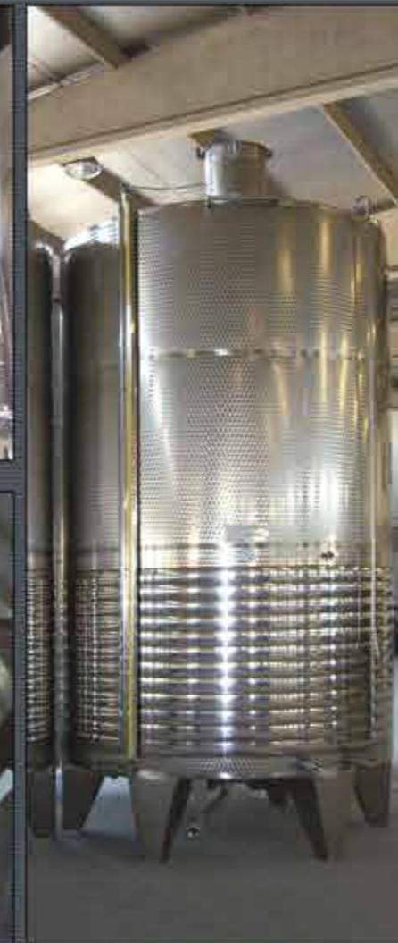
Isıtmalı Zeytinyağı Tankları
