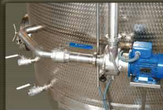
Şıra sirkülasyonu için özel pompa ve boru tesisatı
