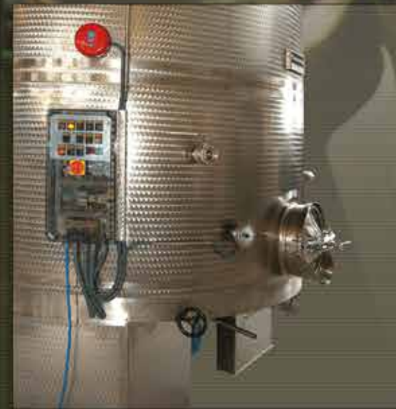
PLC kontrollü otomasyon sistemi
